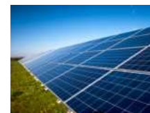
Centrale au Sol
